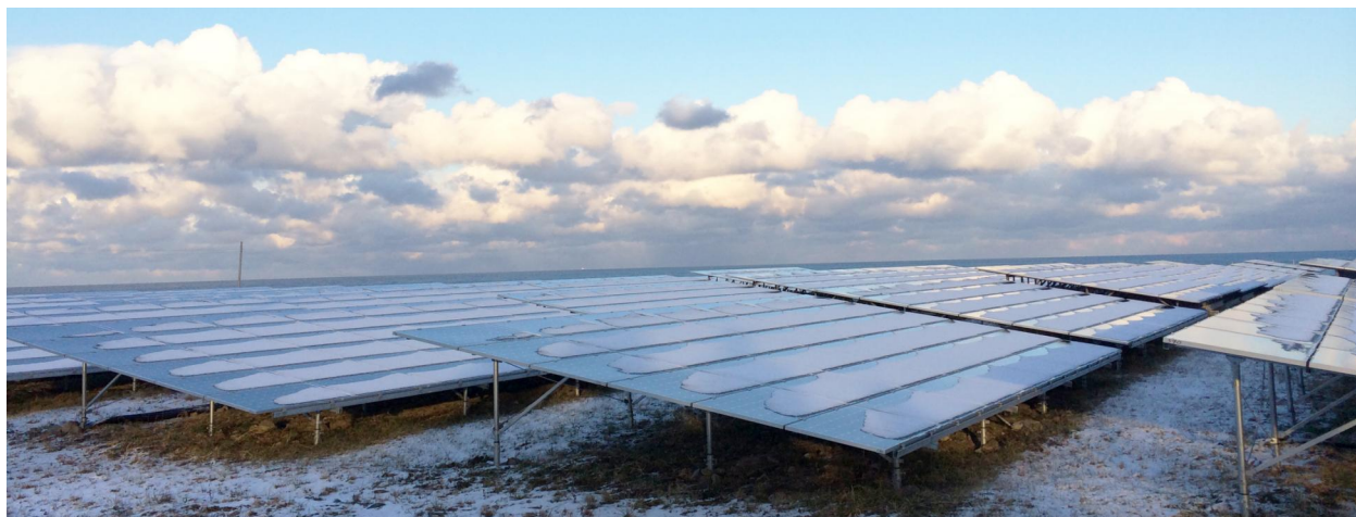
装机容量：12MWp 项目地点：日本
