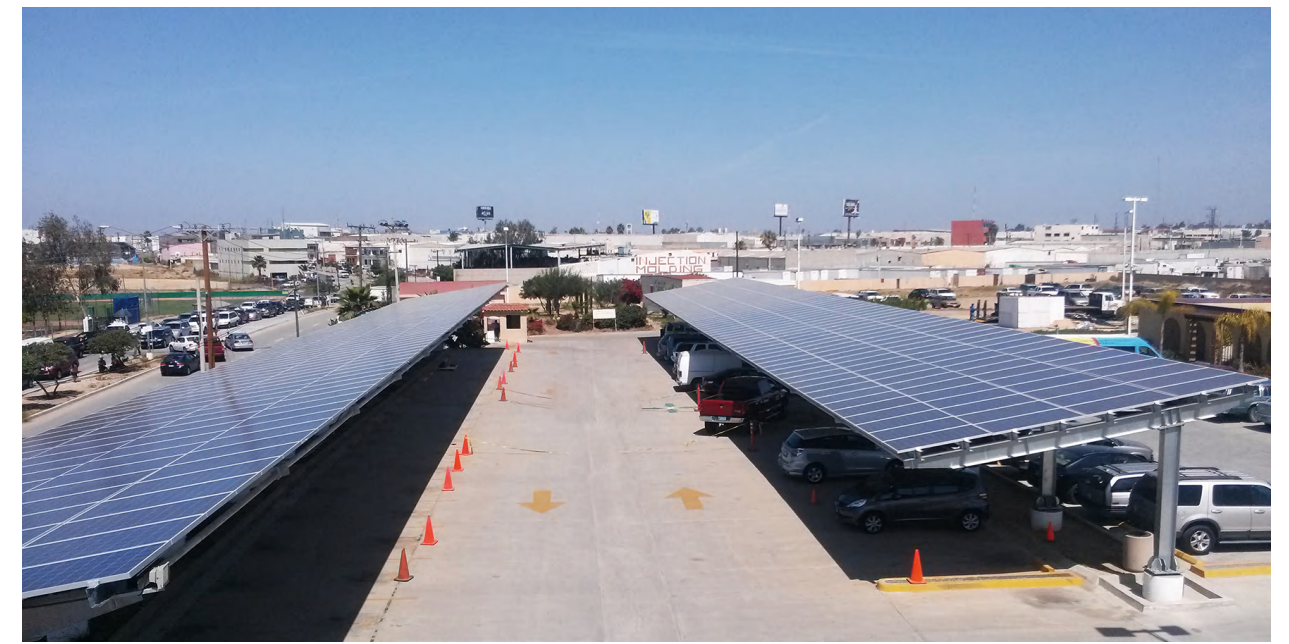
装机容量：1MWp 项目地点：墨西哥
