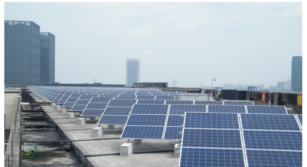
装机容量：5MWp 项目地点：嘉兴
