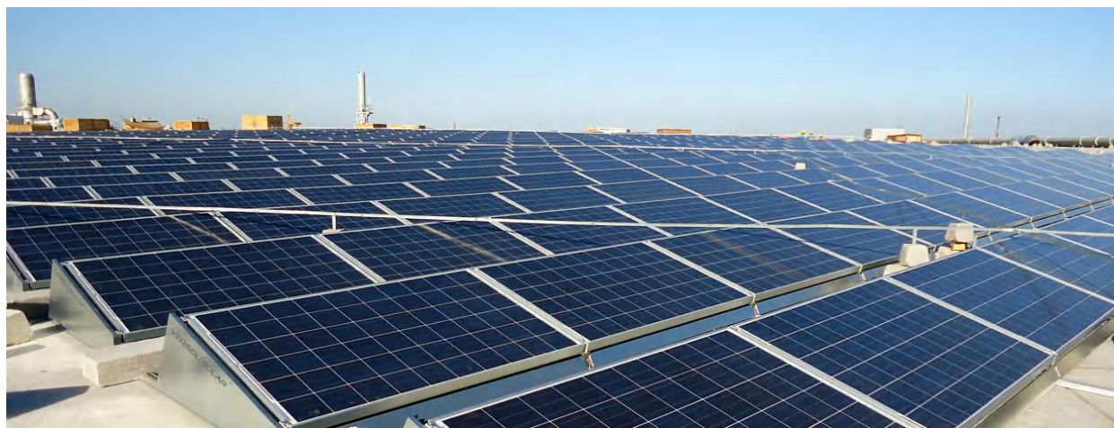
装机容量：2MWp 项目地点：北京
