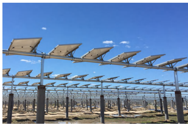
装机容量：100MWp 项目地点：吉林白城 产品类型：帷联跟踪系统
