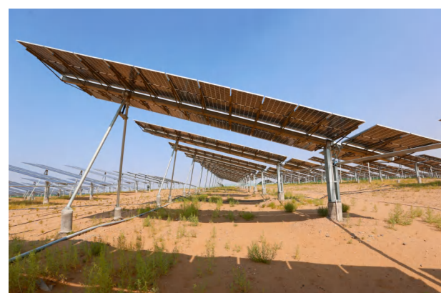
装机容量：115MWp 项目地点：内蒙古达拉特旗 产品类型：斜单轴跟踪系统
